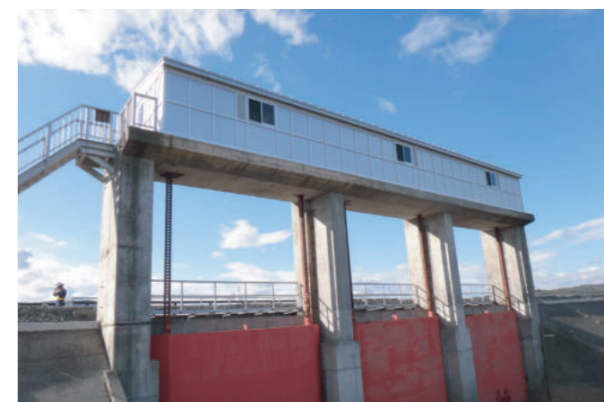
岩手県 県北広域振興局 土木部 泉沢水門 W=2,800 B=21,700 H=2,100
