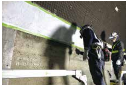
国土交通省 近畿地方整備局 国道2号夢前トンネル塗装補修工事
